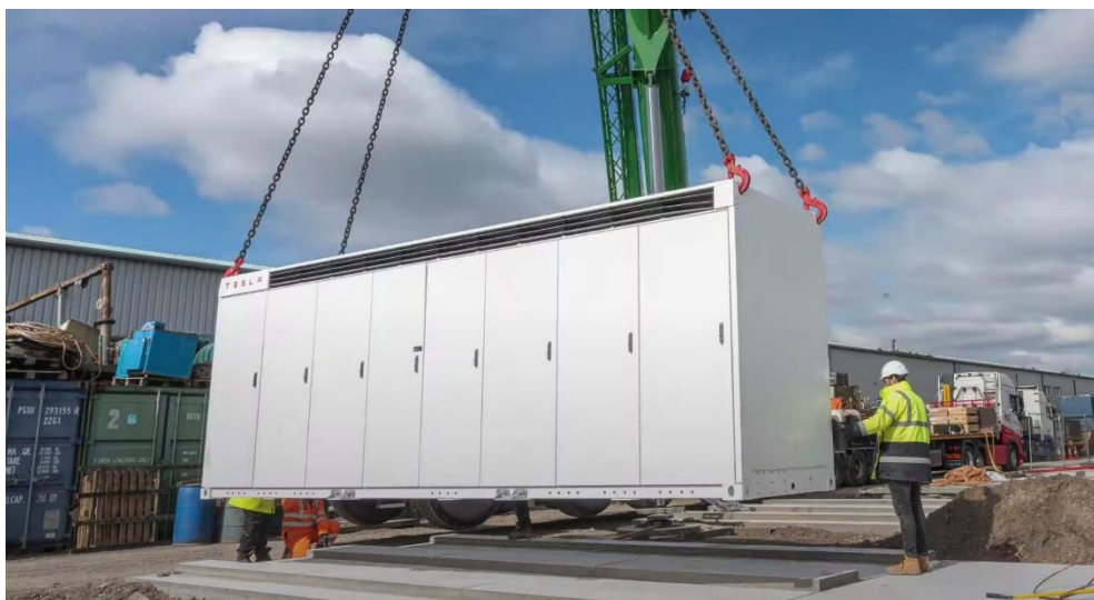
Slika 2.13 Fotografija instalacije baterijskog sustava Tesla Megapack kapaciteta 15 MWh zasnovanog na litij-ionskim baterijama
